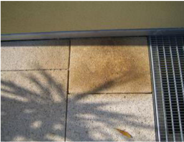
rostiger Splitt im Unterbau
